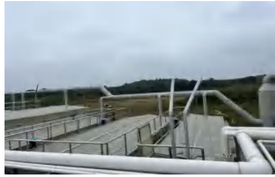
粪污水处理系统恶臭加盖收集
