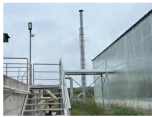
生物除臭塔排气筒
