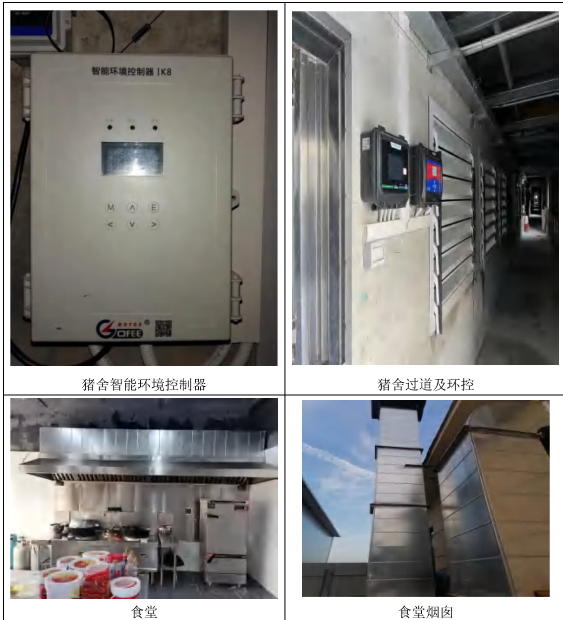
图 4-6 项目废气处理设施
