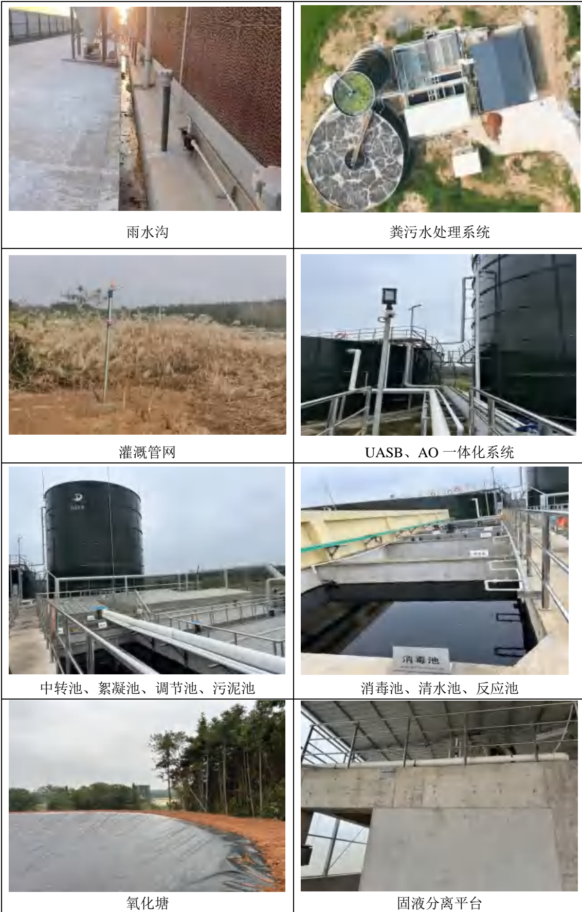
图 4-1 项目废水处理设施
